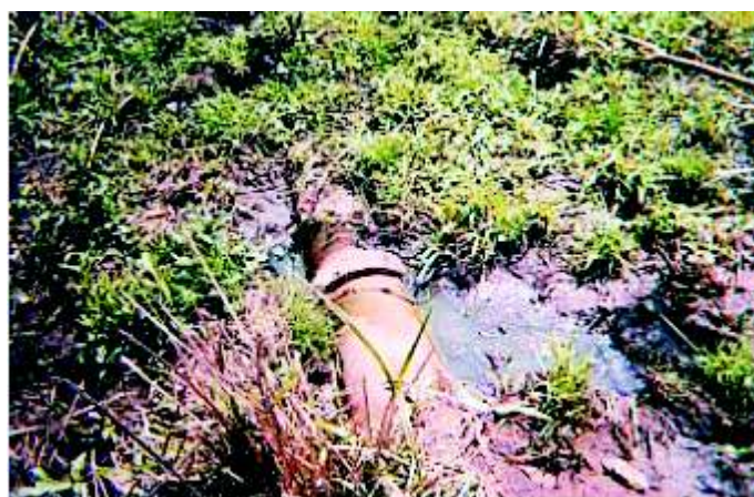
Figura 3. Fotografia de tubulação com vazamentos.
