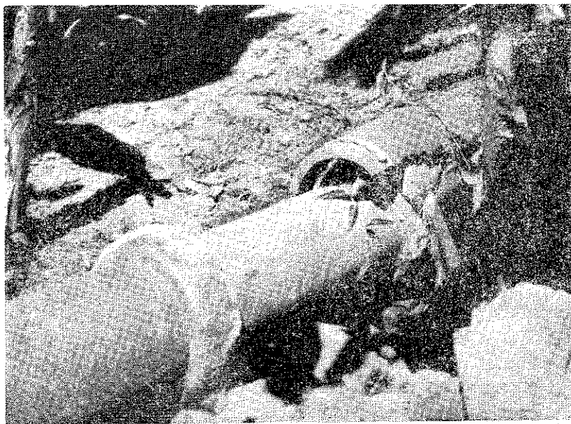
Fig. 8 — Ruptura de manilha do esgôto. Cidade de PINDAMONHANGABA.
