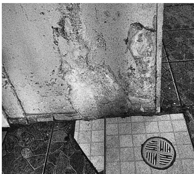
Falta manutenção predial
